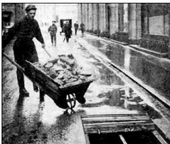
Рис. 1. Паровая снеготаяльная установка на ул. Ильинка: люк для загрузки снега
